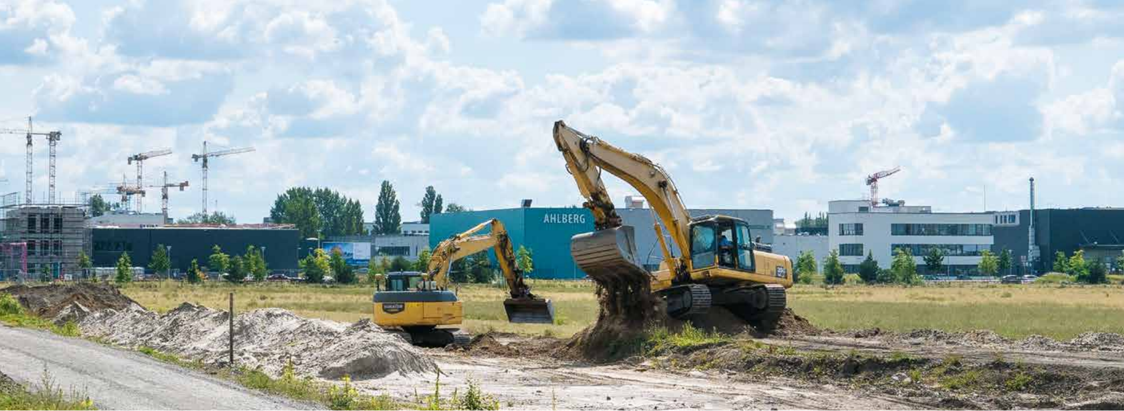
Beginn der Straßenbauarbeiten für die Verlängerung der Wagner-Régeny-Straße Road works start for the elongation of Wagner-Régeny-Straße
