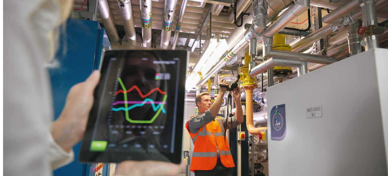
Messen, steuern, überwachen: Die Technikzentralen von Gebäuden werden immer komplexer. Measuring, controlling, monitoring: building control systems grow more and more complex.
